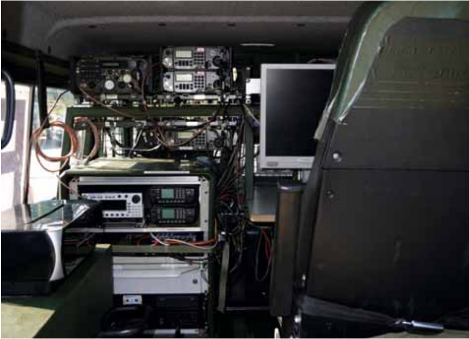
Monitor Installatie OIT Licht MB 7,5kn interieur
