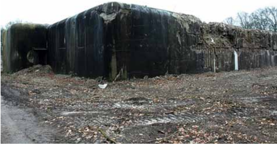
Opname bunker kort na mislukte slooppoging.
