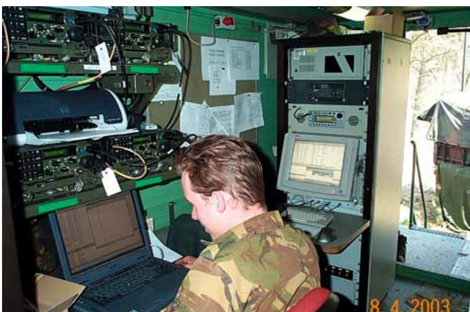
Na goedkeuring van de plannen om de shelters 'digitaal' in te richten werd er een digitaal opname apparatuur ingebouwd in de consoles die door een bedrijf in Winterswijk waren gebouwd en nu voor de modificatie werden aangepast.
