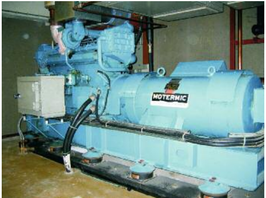
De bunker heeft een groot diesellaggregaat van 300 KVA.
