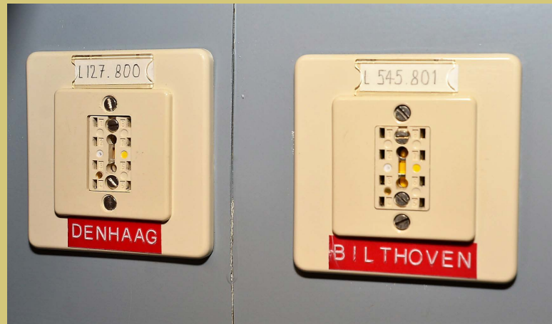
Eindpunten van lokale verbindingen, hier afgewerkt op contactdozen voor 8-polige telegraafstekers. Deze opname is gemaakt in het voormalig hoofdkwartier van de Defensie Pijplijn Organisatie (DPO) in Noordwijk. (Foto: Raphael Smid, 2019)
