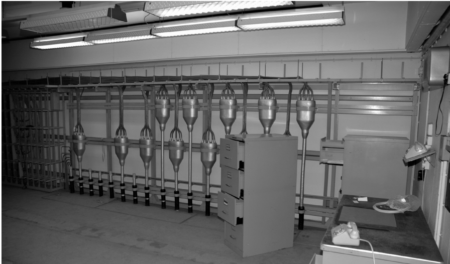
Bunker Oegstgeest, anno 2012. Imposante kabelinvoer van defensie- en PTT-kabels in de voormalige communicatiebunker van defensie aan de Kwaaklaan in Oegstgeest. De zogeheten flessenlassen markeren de overgang van de grondkabels naar het binnenleidingen netwerk. (Foto: Raphael Smid)
